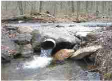
إلقاء مياه الصرف الصحي في الترع شكل (١٣)
